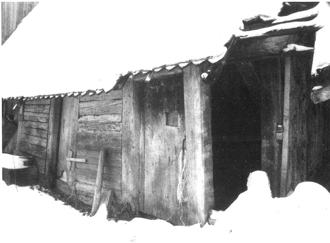
Abb. 14: Ständerwand an der Nordseite des Westhauses mit liegenden Kanthölzern als Wandfüllung. Rechts oben ist die Wandpfette zu sehen, auf der die dünnen Enden der Originalrafen ruhen.
