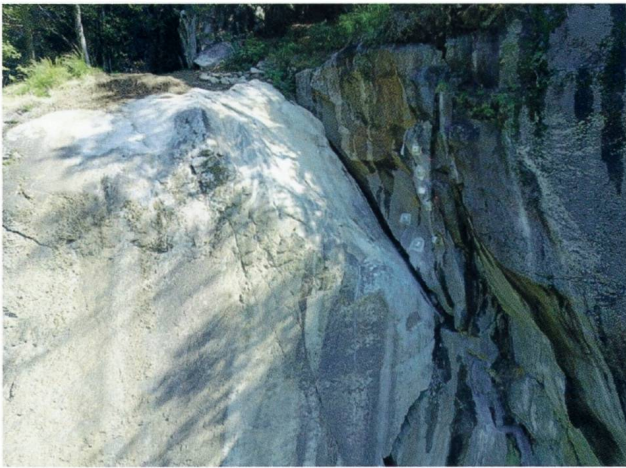
Fig. 10: Blick auf die Sprengstelle nach der Felsreinigung und auf den mit Felsnägeln gesicherten Felspfeiler rechts davon.
