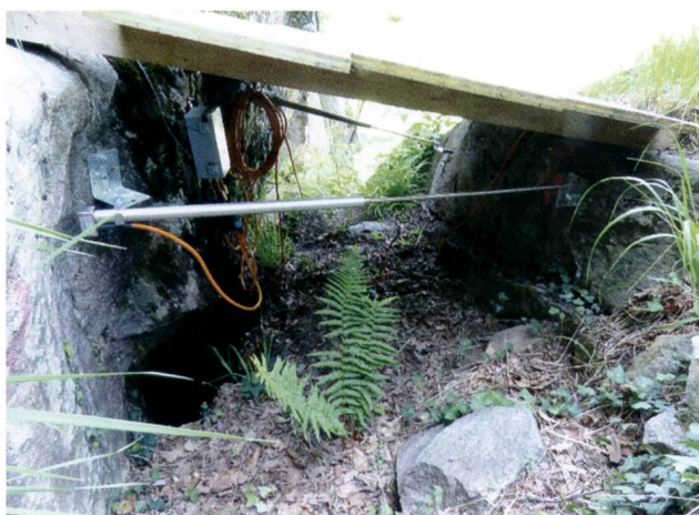
Fig. 6: Die beiden oberen Telejointmeter TJM 1 und TJM 2 sind zwischen dem stabilen Felsverband (links) und der obersten, labilen Felsplatte (rechts) angebracht.
