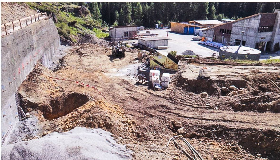
Fig. 4: Lage des freigelegten Karsthohlraumes an der hangseitigen Baugrubenwand (Bild Th. Rüegg, 31.07.2017).
