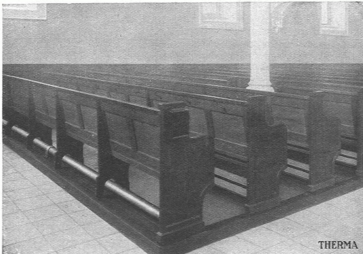
Abb. 1. Fussbankheizung. Unter der hintersten Bankreihe ist das Heizrohr sichtbar, unter den vordern Reihen sind die Rohre durch Holzlatten verdeckt.
