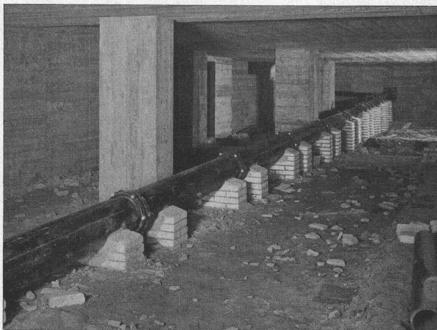
Eine der grossen Ablaufleitungen von 300 mm Ø
