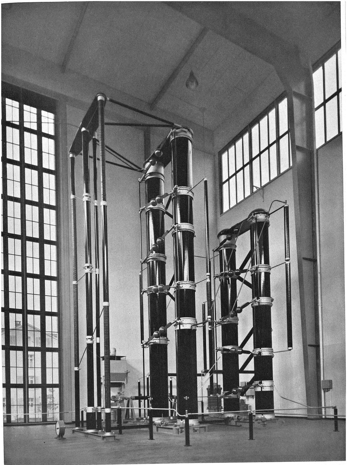
Stoßspannungs-Generator für 2,4 Millionen Volt
