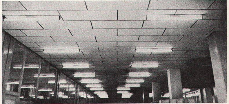
ungelochte Schallschluckplatte, unbrennbar, hier mit sichtbarem Hängerostr in einem Druckereisaa
