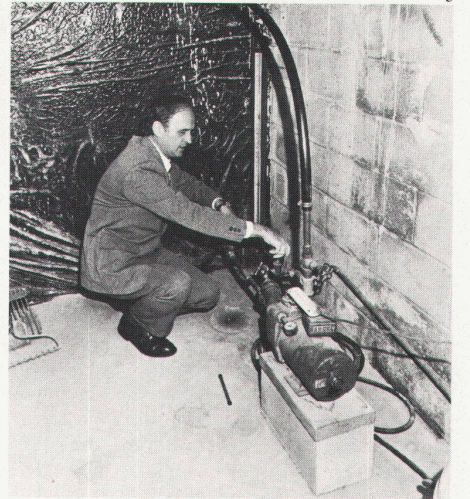
1 La maison solaire de M. Harry Thomason, dans le Maryland. 2 La piscine chauffée à l'énergie solaire. 3 La pompe à eau qui actionne, à la cave, le chauffage solaire.
