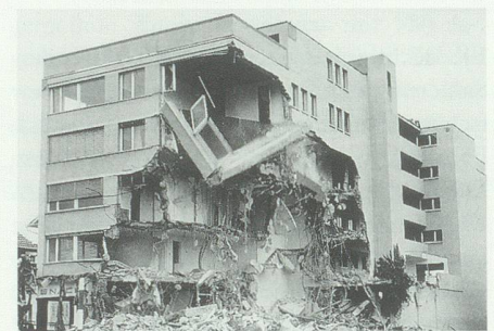
18. Januar: Der 30jährige «City»-Komplex im Zentrum von Buchs wird abgerissen. Er muss einer neuen Grossüberbauung weichen.
