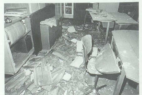
16. Januar: In einem Zimmer des Schulhauses Feld in Azmoos stürzt der Decken-Unterputz ein.
