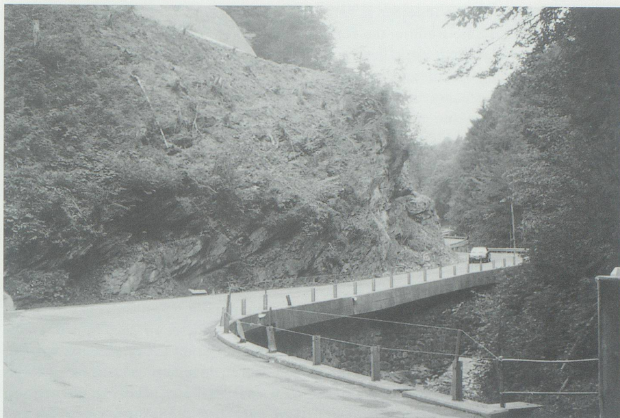
Der Schutzgunten, die baulich und verkehrstechnisch heikelste Stelle der Strecke. Bild 1996: Noldi Kessler, Gams.
