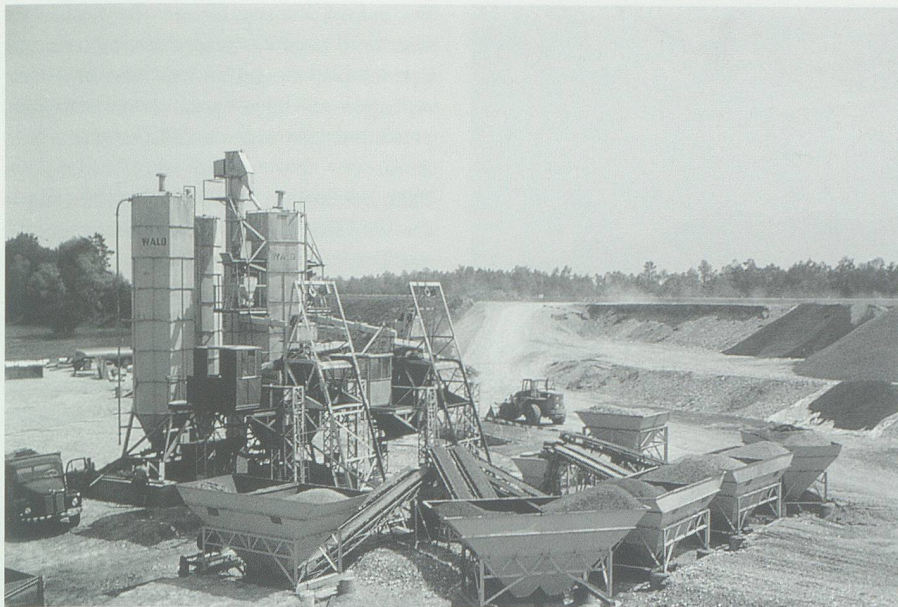
Neben den gewaltigen Staudämmen im Alpenbereich brachte der Autobahnbau die grössten und die Landschaften am meisten umgestaltenden Grossbaustellen. Installationsplatz bei Salez im Jahr 1967. Bild: Ermin Busch, Rorschach.
