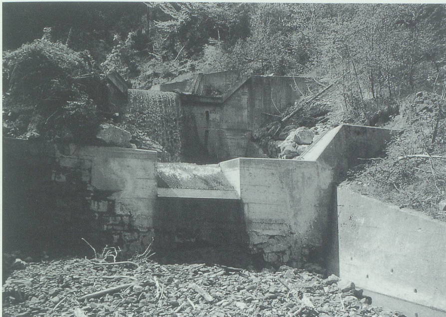
Die neue Fassung im Sevelerbach für das Elektrizitätswerk musste durch massive Mauern geschützt werden. Bild: Eugen Henauer, Buchs.
