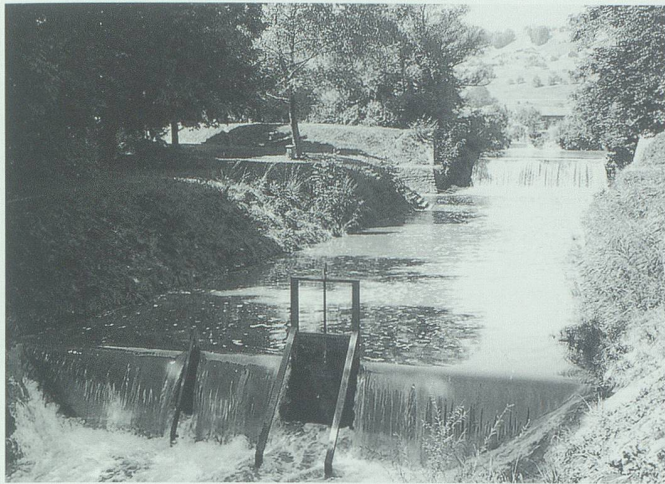
Kiessammler mit Schleusen und einem Nachbecken als Kolkchutz verhindern den Eintrag von Material aus der Simmi in den Binnenkanal. Bild: Eugen Henauer, Buchs.
