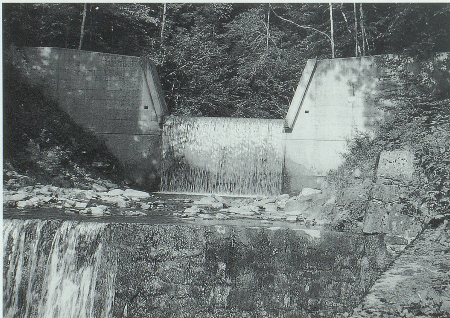
25 Jahre nach dem Bau bemerkt man die Bauten fast nur, wenn sie zufällig durch einen Sonnenstrahl beleuchtet werden. Bild: Eugen Henauer, Buchs.
