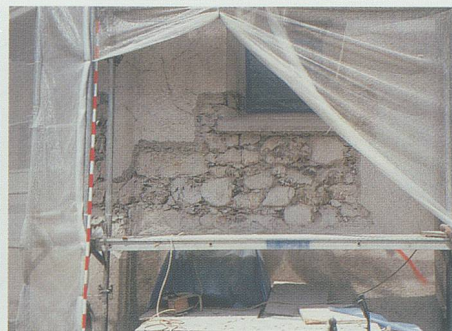
Ostmauer des spätgotischen Chors. In der Südecke ist ein grosser Felsblock (unten links) sichtbar. Bilder: Kantonsarchäologie.
