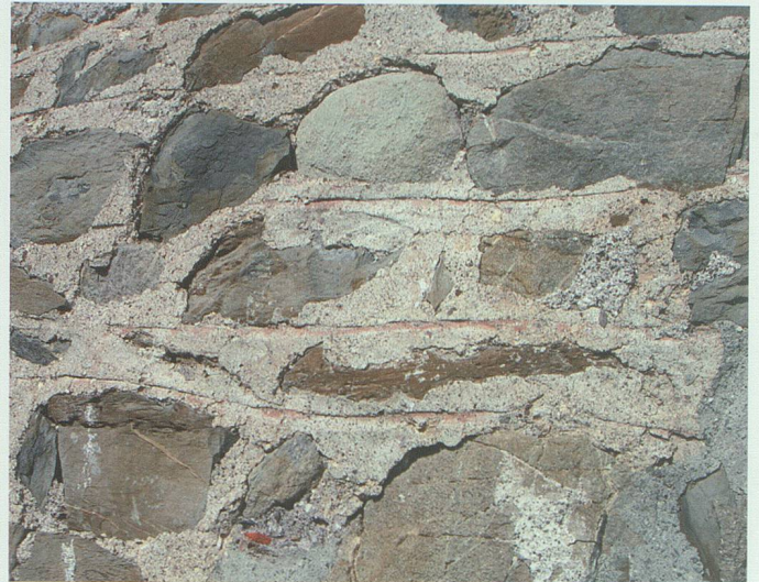
Abb. 16: Beim Rasa-Pietra-Verputz füllte man die Fugen grosszügig mit Mörtel aus und liess die Steinkuppen sichtbar. Bei der Ruine Gräpplang (Flums) brachten die Maurer zudem einen Fugenstrich an.
