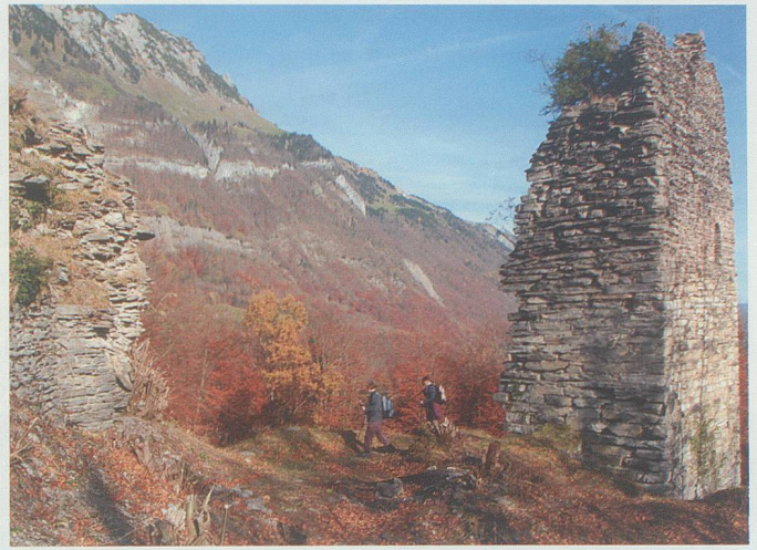
Abb. 47: Turm und Schildmauer (links) der Burg Hohensax sind im Spätherbst 2006 in voller Auflösung begriffen. Die eingeleiteten Sanierungsmassnahmen kommen einer Rettung in letzter Minute gleich!
