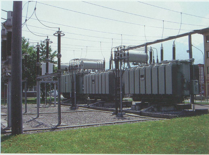
Unterwerk Buchs der St.Gallisch-Appenzellischen Kraftwerke AG.
