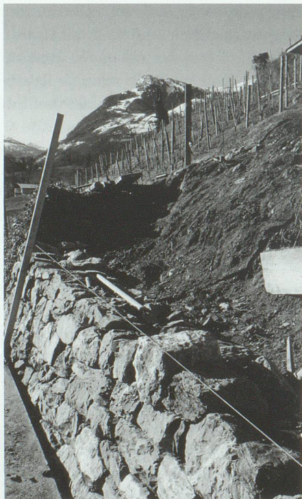
20. Januar: Die Sanierung von Trockenmauern in Wartau wird aus dem Konjunkturpaket des Bundes unterstützt.
