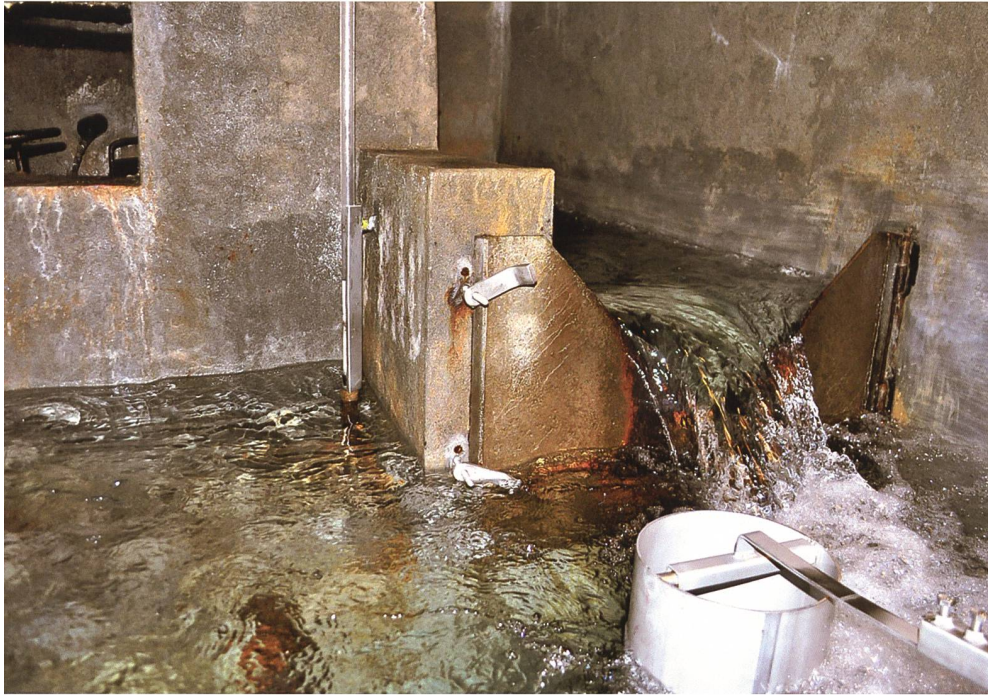
Blick in die Verteilstube Fermärsch: Trinkwasser bester Qualität für die Fieser Berggüter, das Kurhaus Alvier und das Dorf Azmoos.
