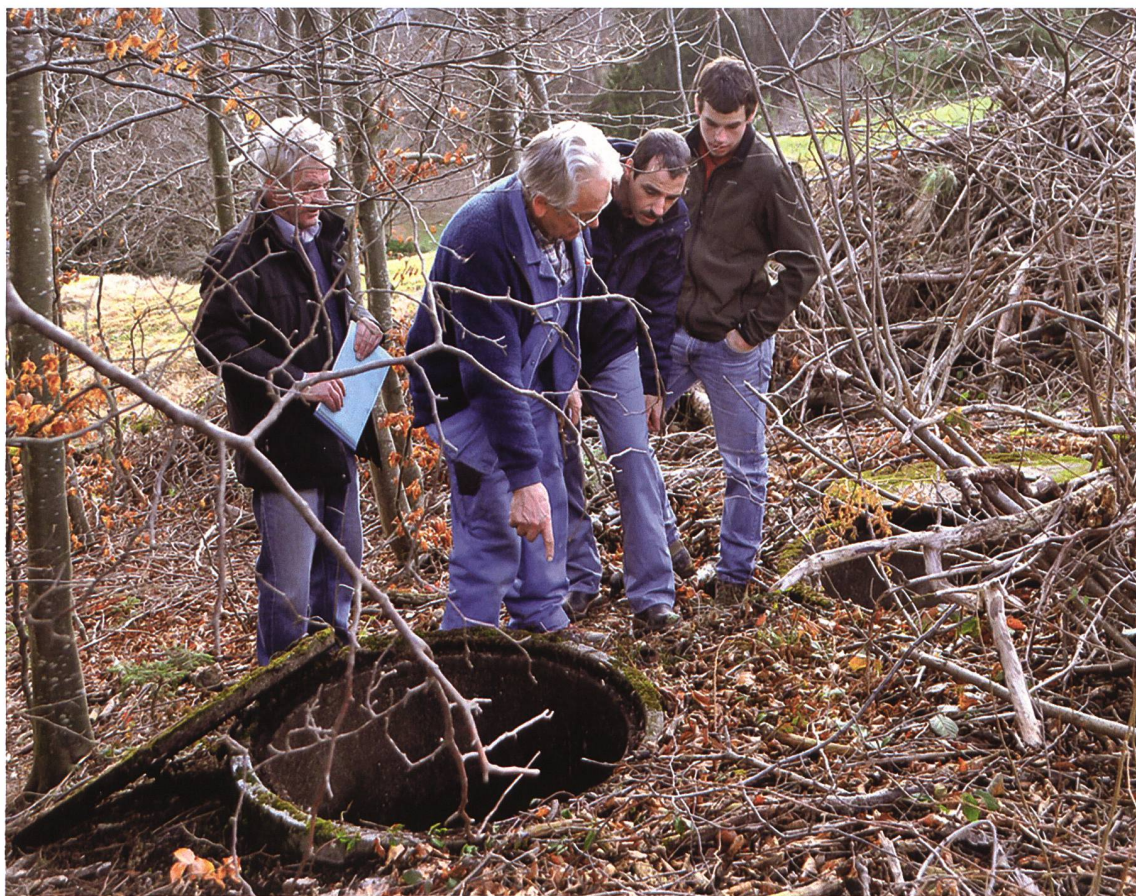
Augenschein beim Ende der Hauptleitung im Büntli, wo sich die privaten Nebenstränge nach links zu den Fiesgütern und rechts zu den Ferienhäusern und in Richtung Malanser Berg teilen.
