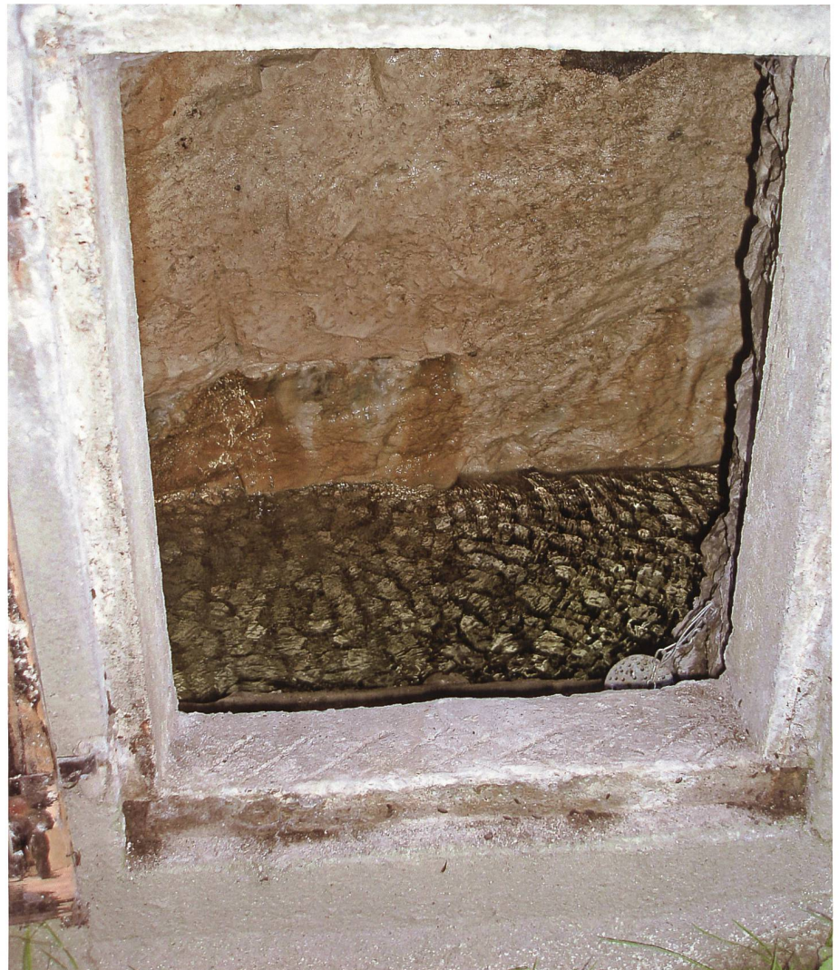
Blick in die Brunnenstube der Hirschnerbrunnenquelle am Fuss des Eichbüels.
