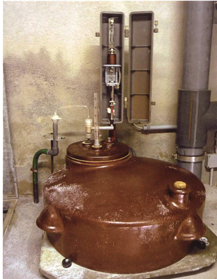
Geöffnete Dosieranlage für Javelwasser im heute ungenutzten Reservoir Löchli.
