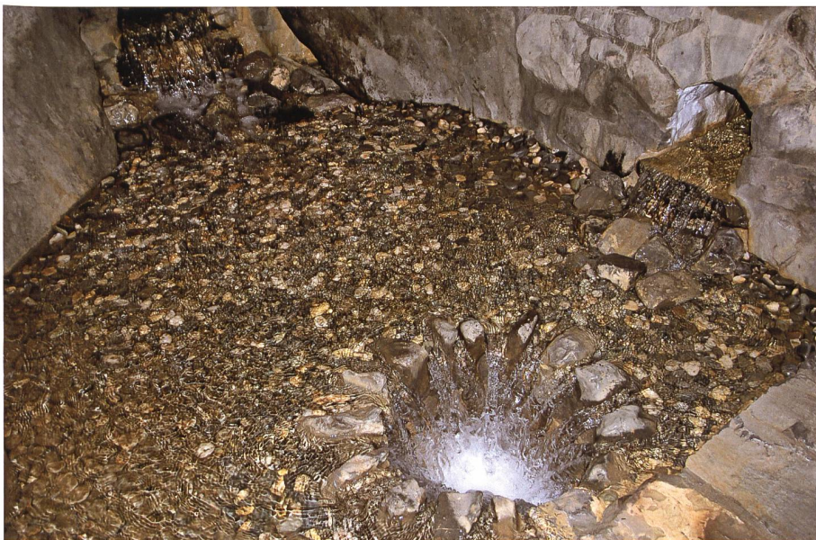
In die Sammelstube Albrechtsbrunnen fliesst das Wasser aus einer frontal gefassten Hauptquelle (oben links) und einer seitlichen kleineren Quelle ein. Foto 2014 Hans Jakob Reich, Salez
