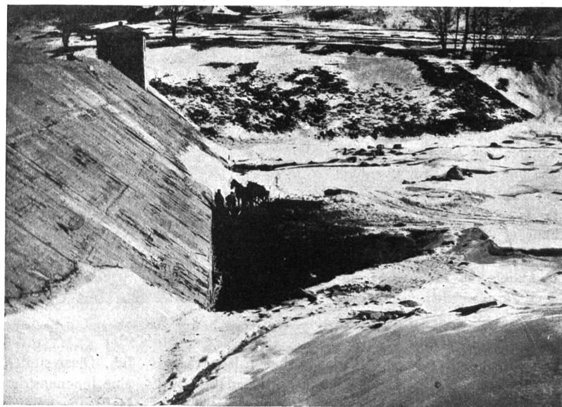
Abbildung 8. Pittsfield-Staudamm nach der Unterspülung, von der Wasserseite gesehen.
