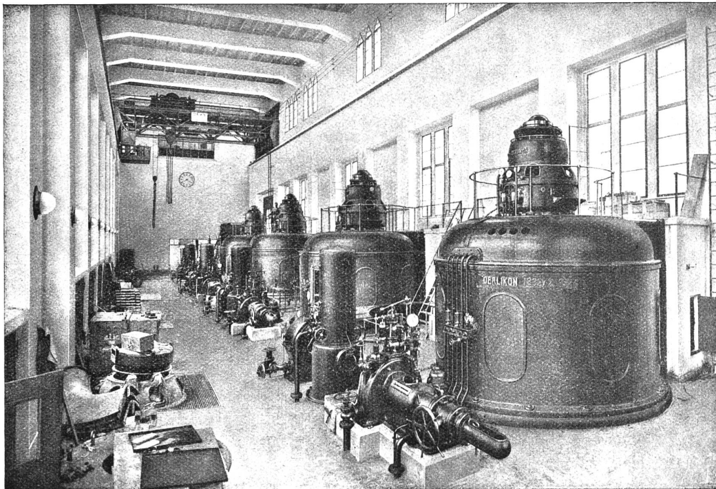
Abb. 24. Wäggital. Inneres der Zentrale Siebnen.
