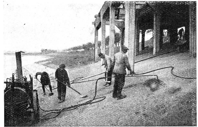
Abb. 4. Herstellung einer Tränkdecke zur Sicherung des Ufers an einer Verladeanlage bei Monheim am Rhein.
