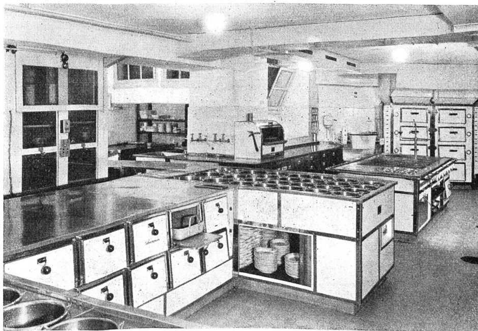
Abb. 9 Gesamtüberblick der Küche mit den elektrischen Herden und den Bains-Marie
