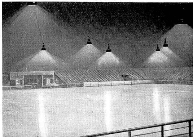
Abb. 29 Beleuchtung der Basler Kunsteisbahn.
