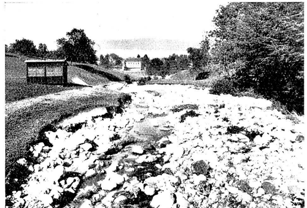
Abb. 8 Der Mühlebach bei Richterswil. Ausweitung des Bettes oberhalb der Ortschaft Elargissement du lit d'un ruisseau en amont de Richterswil
