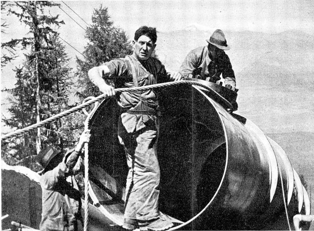
Abb. 13 Erstellen der Druck- leitung des Dixence- Kraftwerkes (Wallis) (Aus dem Film: Unsichtbare Kraft)
