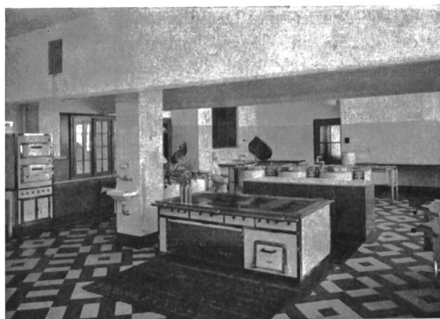
Fig. 64 Teilansicht der elektrischen Küchenanlage des Niederländischen Sanatoriums, Davos.
