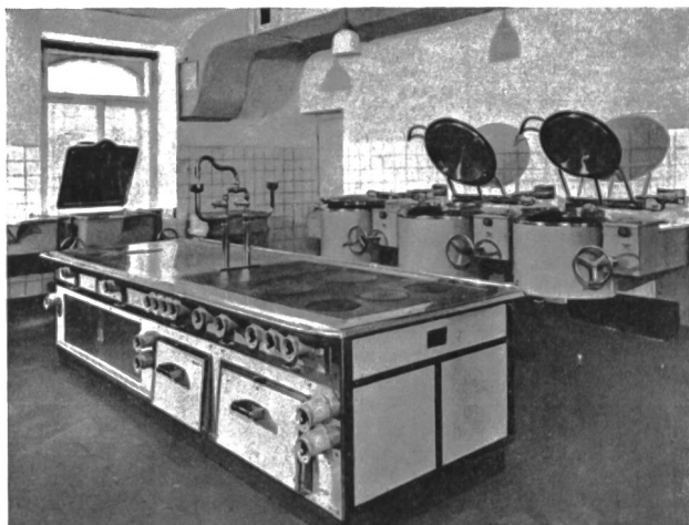
Fig. 63 Teilansicht der elektrischen Küchenanlage des Sanatoriums «Du Midi», Davos, S. B. V. K.
