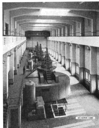
Fig. 24 L'usine de Verbois avec alternateurs Sécheron.
