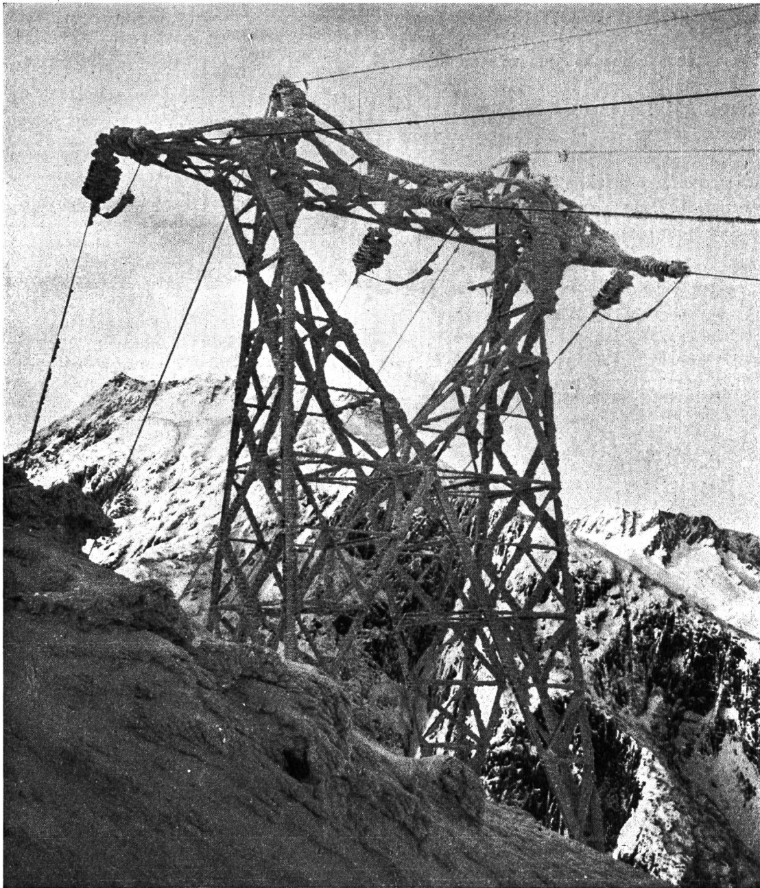
Abb. 15 Abspannmast der Gotthardleitung
