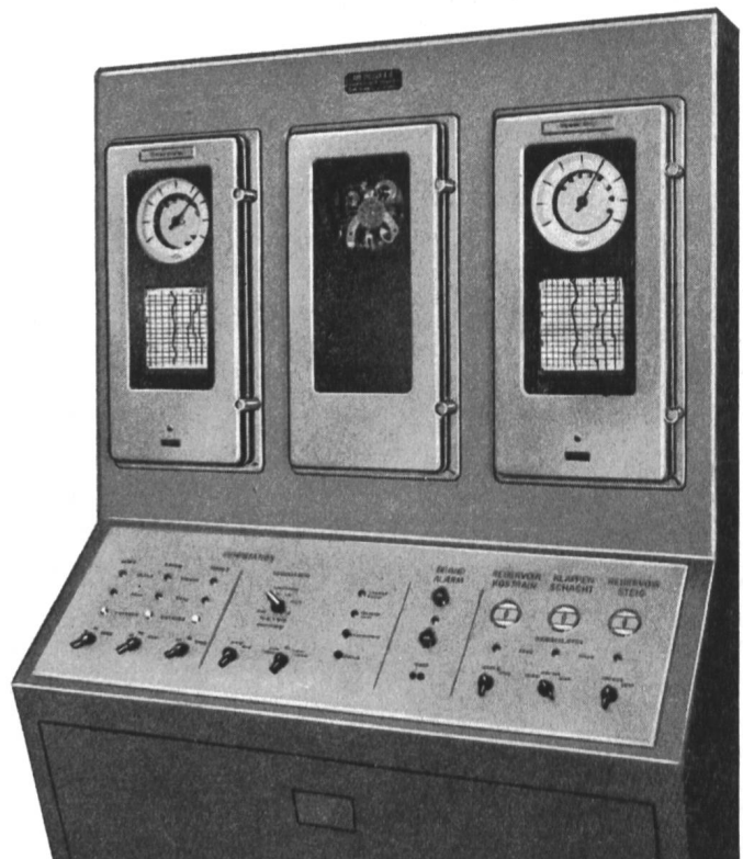
Kommandopult einer Wasserstandsfernmeldeanlage mit automat. Pumpenfernsteuerung
