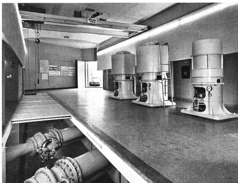
Bild 3 Seewasserwerk II, Pumpwerk Tiefenbrunnen; Innenaufnahme
