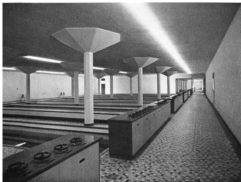
Bild 5 Halle der Schnellfiltergruppe 1 mit Sicht in die Halle der Schnellfiltergruppe 2; im Vordergrund Steuerpulte
