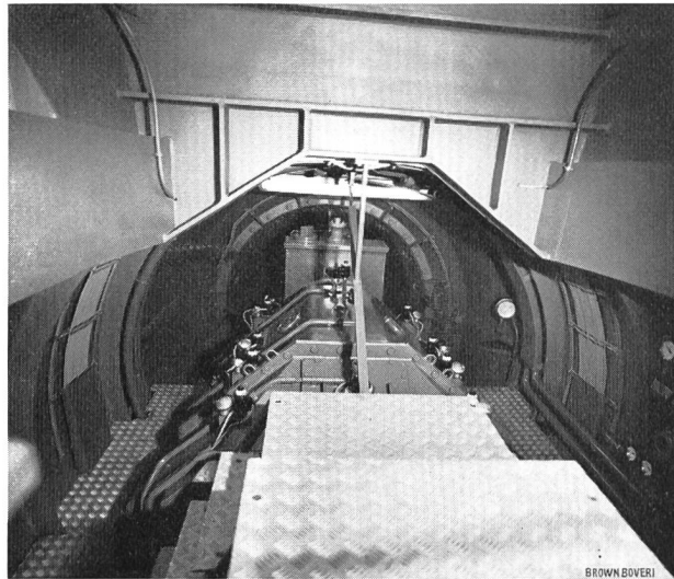
Fig. 5 Im Inneren des geräumigen Rohrgehäuses mit Blick gegen Stirnradgetriebe, Spurlager und die inneren Wasserführungspartien.
