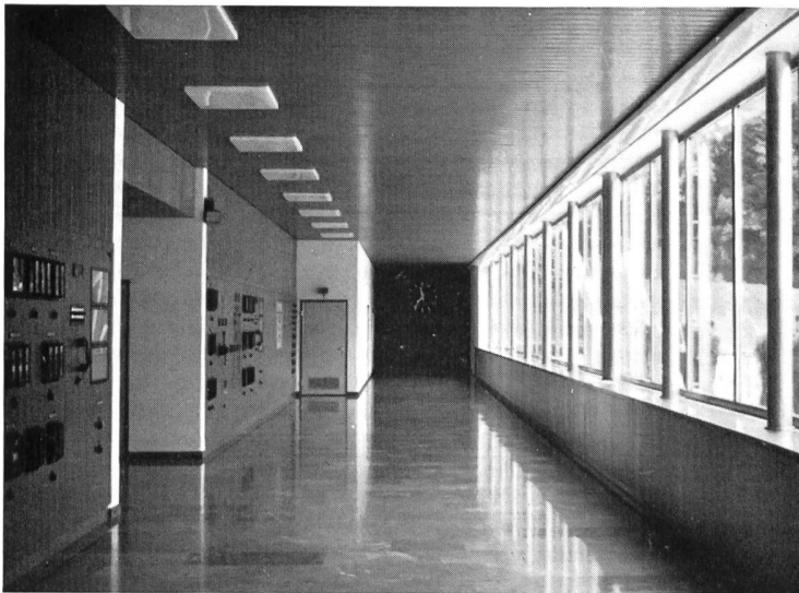
Bild 2 Blick in den Innenraum der Zentrale Schaffhausen.
