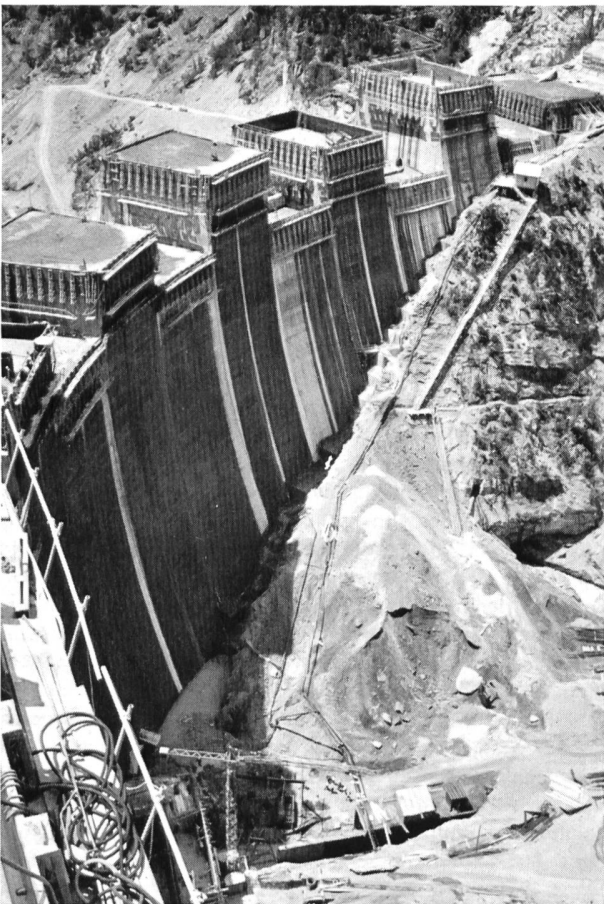
Bild 14 Talsperre Punt dal Gall, die am 1. Juli 1967 bereits 59 Prozent des gesamten Betonvolumens umfasste.
