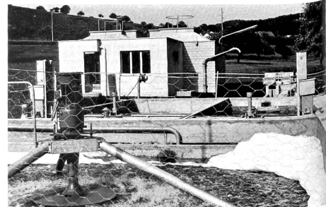
Bild 4 Oberflächenbelüftung in der Kläranlage Tegerfelden (Blockbauweise).
