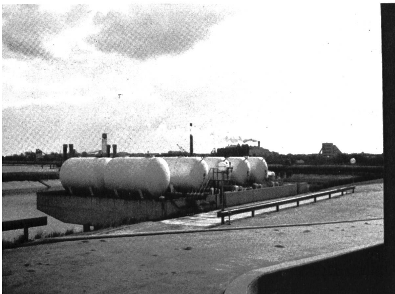
Bild 18 (unten) Tanks mit Chlor und Fluor für die chemische Aufbereitung des Trinkwassers
