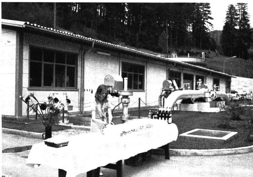
Bild 5 Teilansicht der Druckreduzier-Station Rongellen
