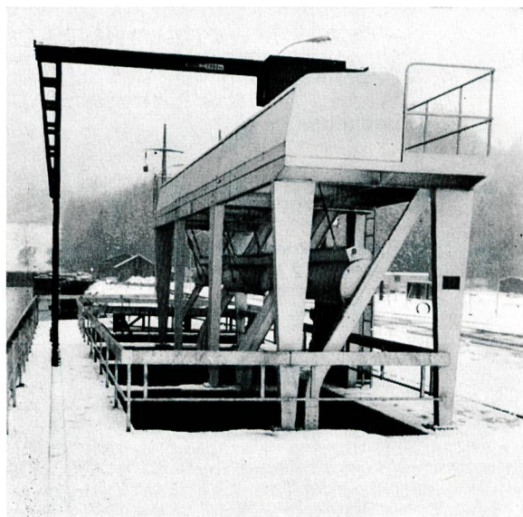
Kühlwasserfassungen der Atomkraftwerke Beznau I+II Je 3 Rechen und automatische, stationäre Rechen-Reinigungsmaschinen
