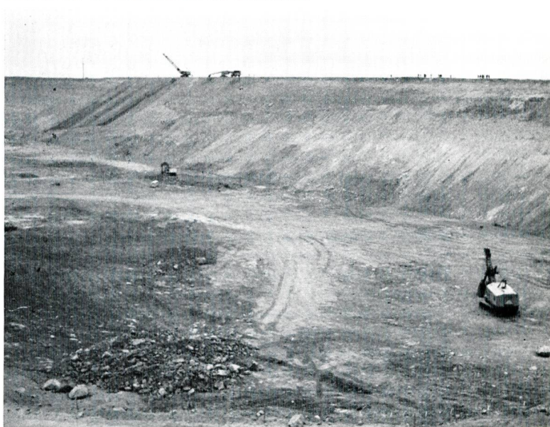
Bild 4 Teilansicht des oberen, rund vier Mio m 3 fassenden Pumpspeicherbeckens der Hornbergstufe. Hinsichtlich der Dimensionen beachte man die Menschen auf der Dammkrone.
