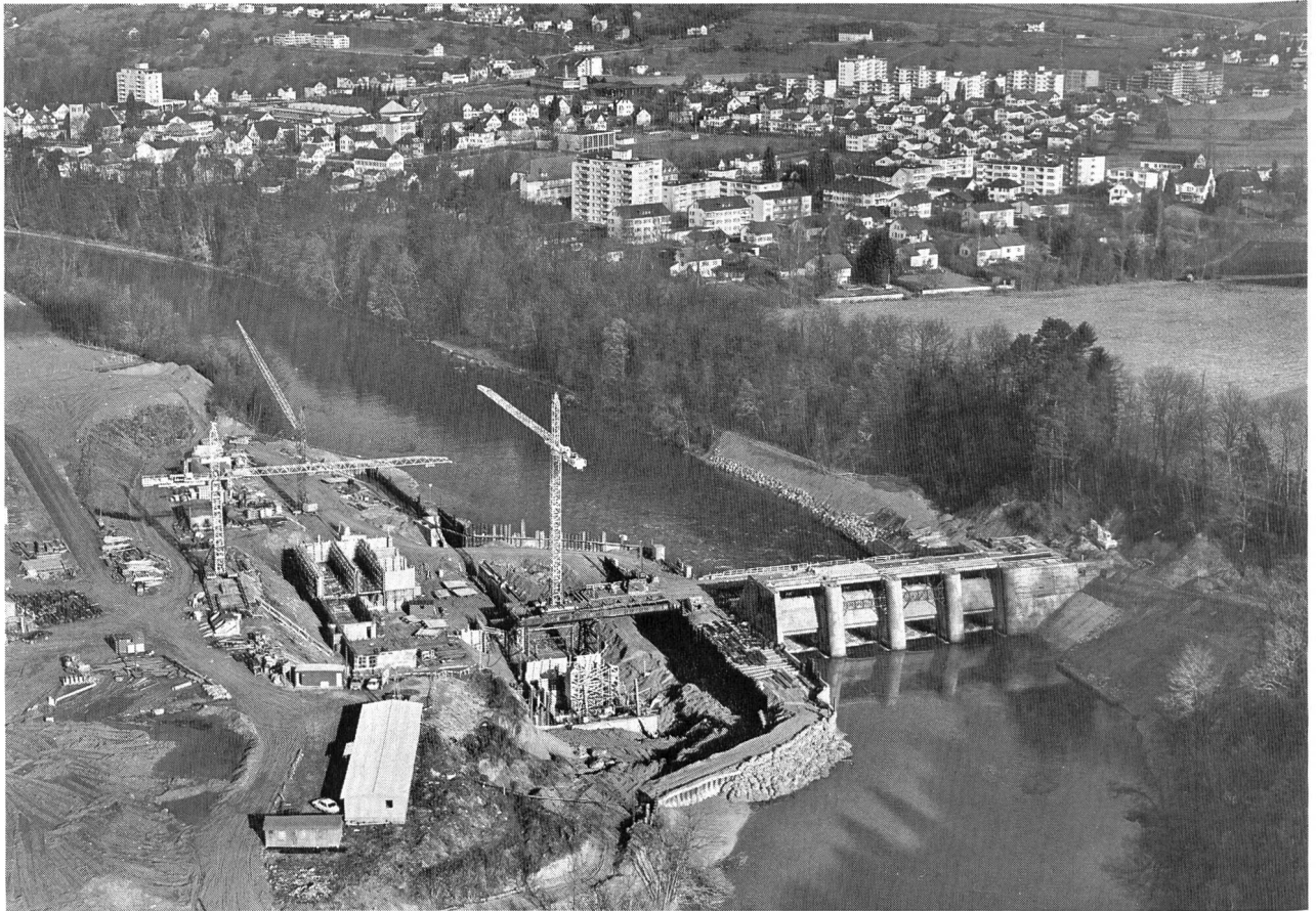
Bild 5 Flugaufnahme der Baustelle für Maschinenhaus und Wehr des Reusskraftwerkes Bremsgarten-Zufikon: Rechts die Wehrröffnungen 2 bis 5, in der Bildmitte die Maschinenhausbaugrube, links das Unterwerk (Photo Comet, Zürich, vom 8. 1. 74).
