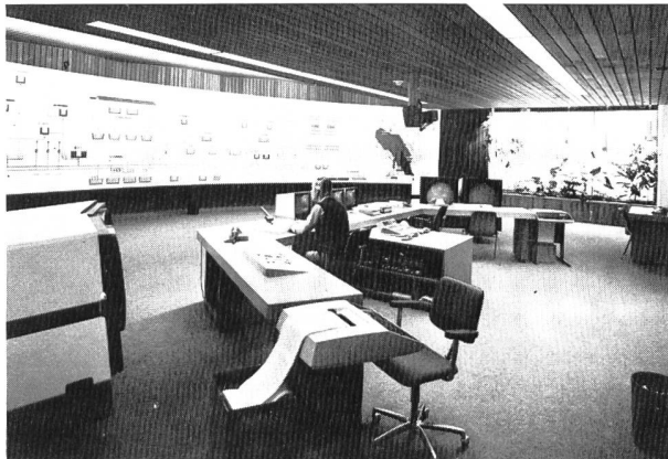
Bild 53. Die Fernwirkzentrale Hardhof der Wasserversorgung der Stadt Zürich.
