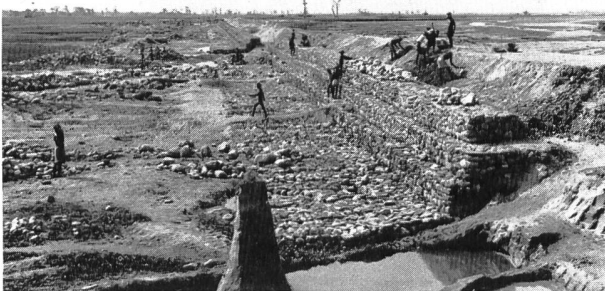
Bild 3. Flussverbau im Terai: Es entsteht ein Hochwasserschutzdamm gegen die Fluten des Ninda-Flusses im Ostterai. Die Drahtschotterbauweise ist sehr beliebt, auch wenn sie nicht unproblematisch ist mit stark gerundeten Steinen und oft ungenügenden Fundationen.
