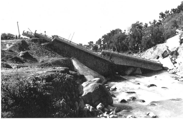
Bild 2. Kurz vor ihrer Fertigstellung im Sommer 1978 wurde diese Stahlbetonbrücke bei Butwal (Zentralnepal) im Terai zerstört. Sie hätte den Tinau Khola (Einzugsgebiet 550 km 2 ) überqueren sollen (East-West-Highway). Das ungenügende Fundament der Brücke widerstand der unerwartet grossen Seitenerosion des Flusses nicht.
