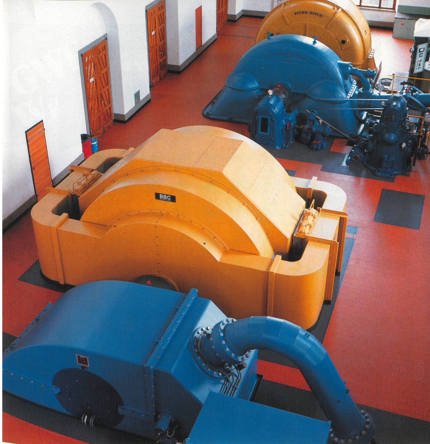
10-MVA-Einphasen-Wasserkraftgenerator für 16 \frac{2}{3} Hz der Bündner Kraftwerke in Klosters. Die neue Maschine wurde anstelle einer alten 10-MVA-Dreiphasenmaschine für 50 Hz eingebaut. Trotz knappster Platzverhältnisse konnte der Einbau des neuen Generators mit dreifacher Typenleistung realisiert werden. Photo Brown Boveri
