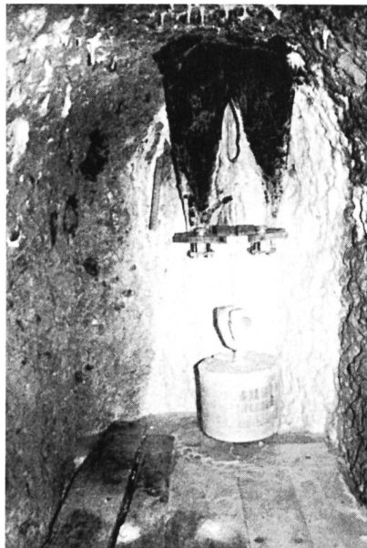
Bild 5. Staumauer Spitallamm. Alte Lotanlage vor dem Umbau mit starken Versinterungen.
