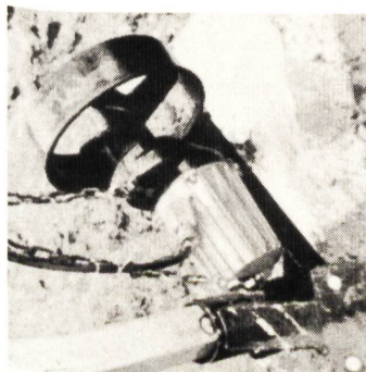
Rührwerke in Schlammstapelgruben von Kläranlagen
