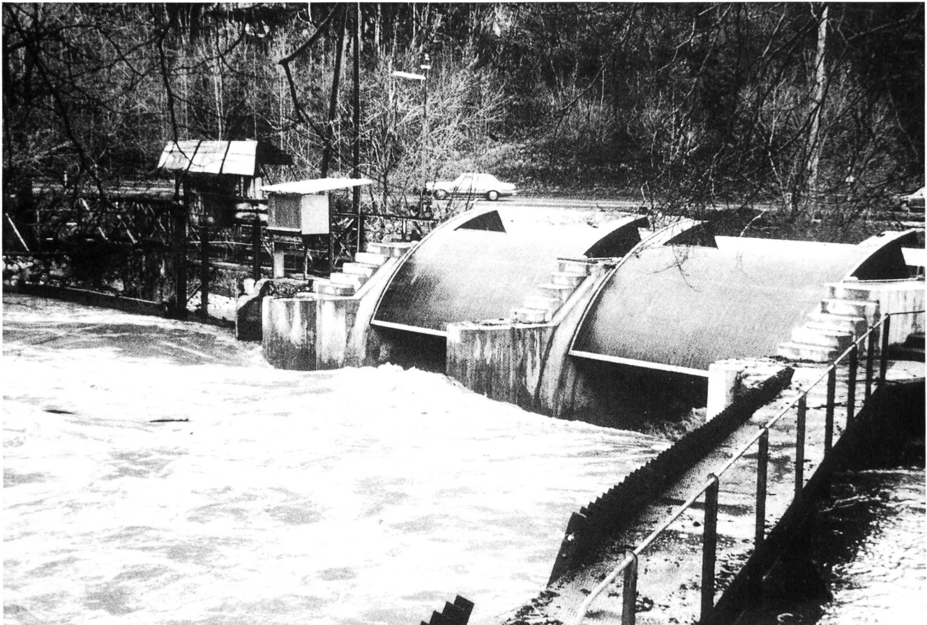
Zwei Segmentschützen mit aufgesetzten Klappen. Anlage an der Birs.
