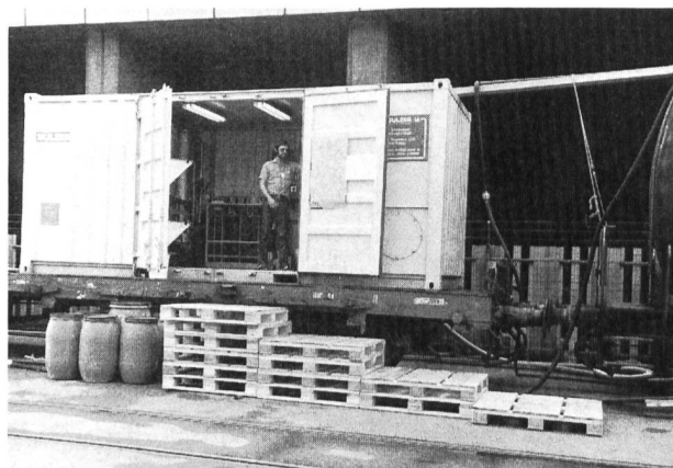
Transportable Wasserbehandlungsanlage, mit der benzinverschmutzte Abwässer von einem Grossbrand gereinigt werden.
