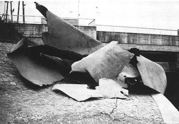
Bild 6. Teil der herausgerissenen und aus dem Unterwasser geborgenen Tosbeckenpanzerung.
