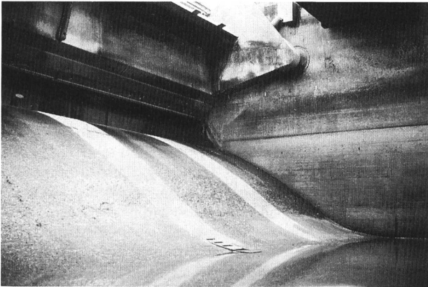
Bild 5. Zustand des Überfallrückens in Wehröffnung 2 im Herbst 1987. Die mit Beton sanierten Stellen sind am Fuss des Überfallrückens gut erkennbar.
