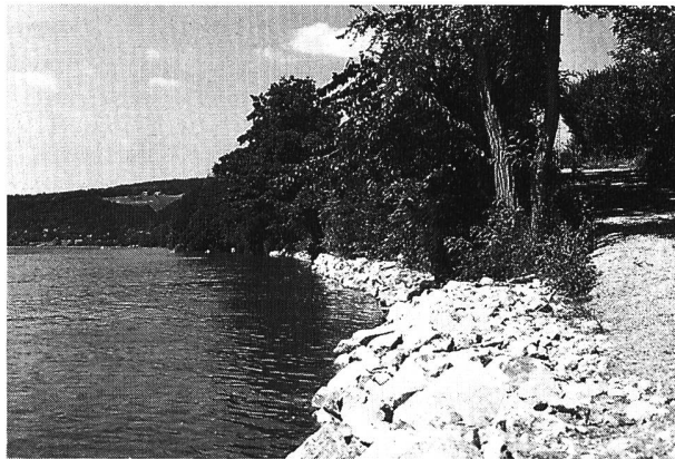
Bild 4. Gleicher Standort wie Bild 3. Schon im folgenden Sommer präsentiert sich die sanierte und für die Bauarbeiten teils gerodete Böschung in saftigem Grün. Auch hier liegt der Wasserspiegel tief. Bei maximalem Stauspiegel wäre lediglich noch die obere Steinreihe sichtbar.
